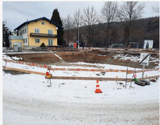
Der Bau des Sickerbeckens im Erlenweg ist eine Auflage, die der Stadtgemeinde aus Hochwasserschutzgründen vorgeschrieben wurde.
